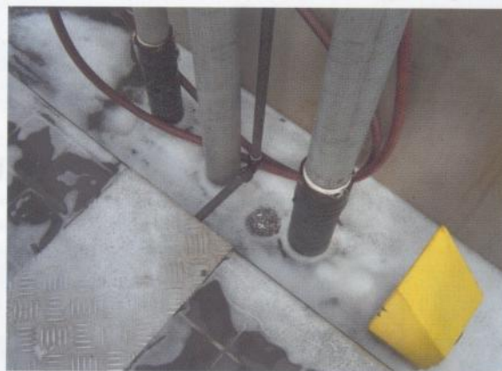
Lekkage rond doorvoeren.
