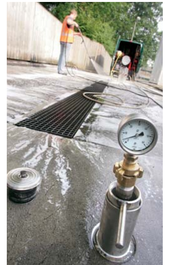
De grond onder de vloer wordt onder druk gezet. Door de overdruk zoekt de lucht een weg naar boven.
